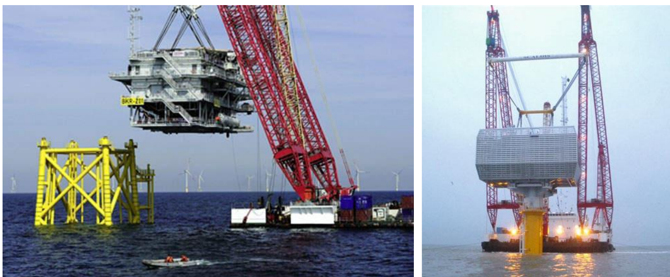
1.5.3 pav. Jūrinės transformatorių pastotės iliustracijos 21
