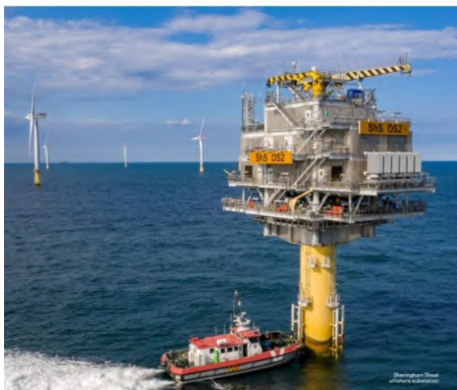
1.1.3 pav. Sheringham Shoal jūrinė transformatorių pastotė 7 .
